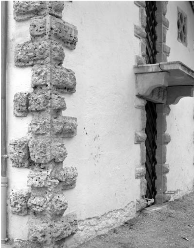
Fabrique de Jardin : détail de la mise en oeuvre des matériaux sur la façade postérieure. 70, Gray rue Victor Hugo
