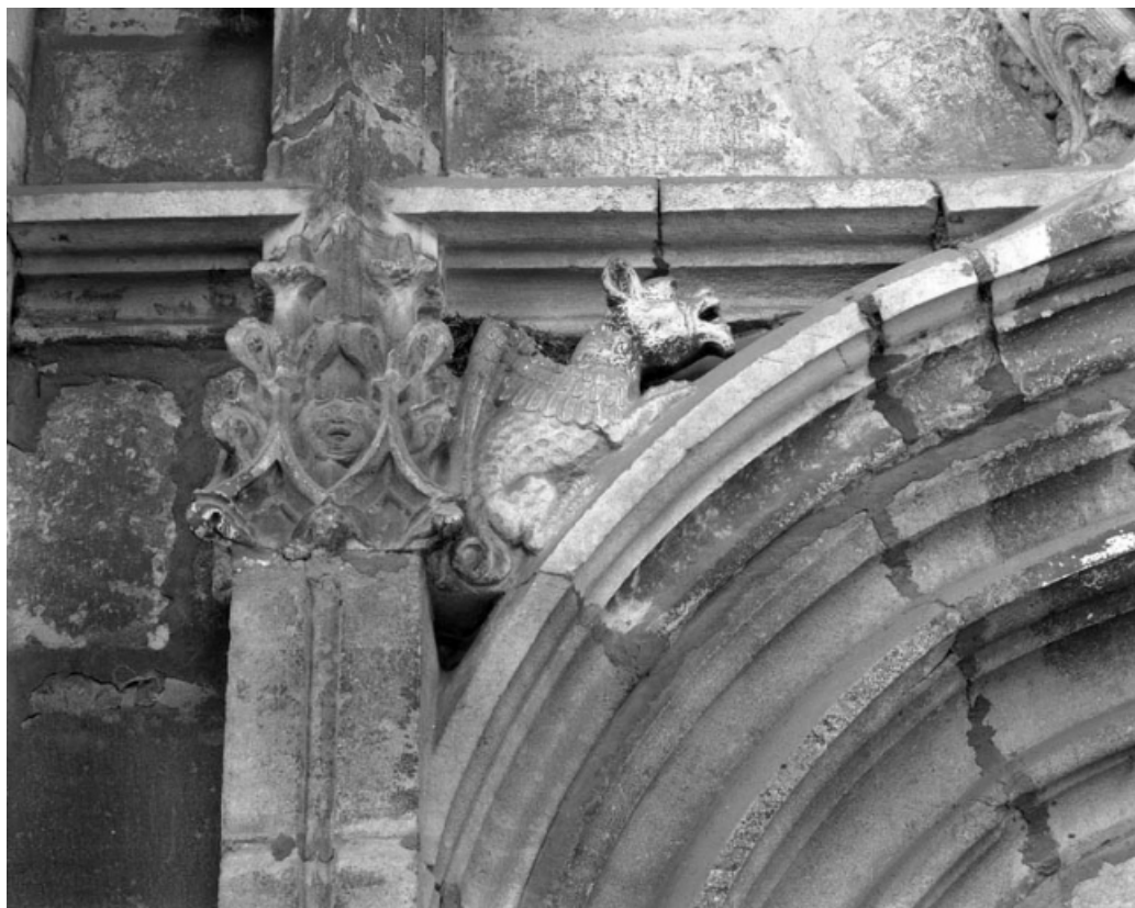
Façade antérieure, portail : détail de l'écoignon figuré gauche de la porte d'entrée droite. 70, Gray place de la Sous-Préfecture
