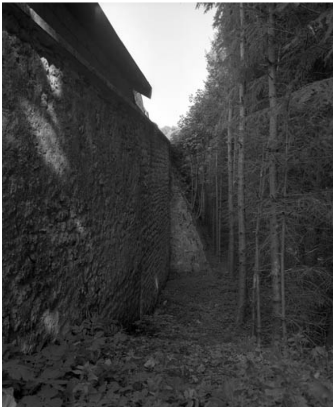
Restes de rempart du bastion de la Visitation (derrière la rue Cécile) : de trois quarts gauche. 70, Gray
