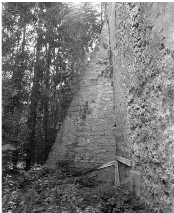
Restes de rempart du bastion de la Visitation (derrière la rue Cécile) : détail d'un contrefort. 70, Gray
