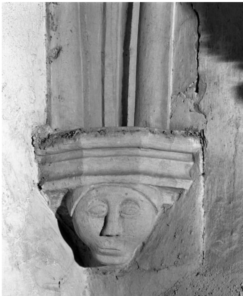
Deuxième chapelle gauche, 1ère travée, culot antérieur gauche 21, Seurre rue des Ecoles
