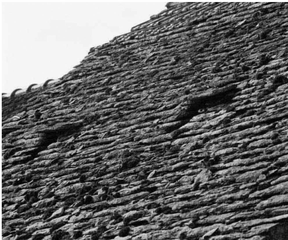
Détail de la couverture de la maison sise parcelle 1094, section C6 sur le cadastre de 1967. 21, Santenay
