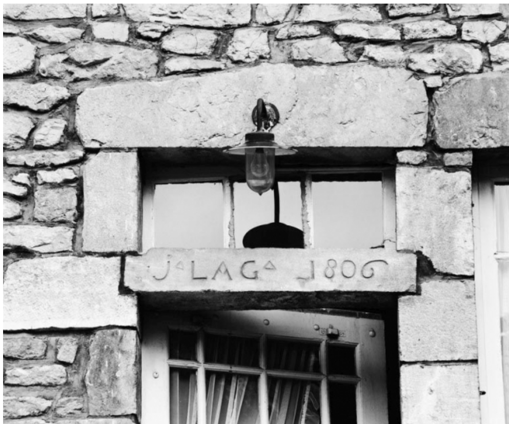
Détail de la fenêtre en dessus de porte de la maison sise parcelle 1311, section D7 du cadastre de 1940. 21, Saint-Romain
