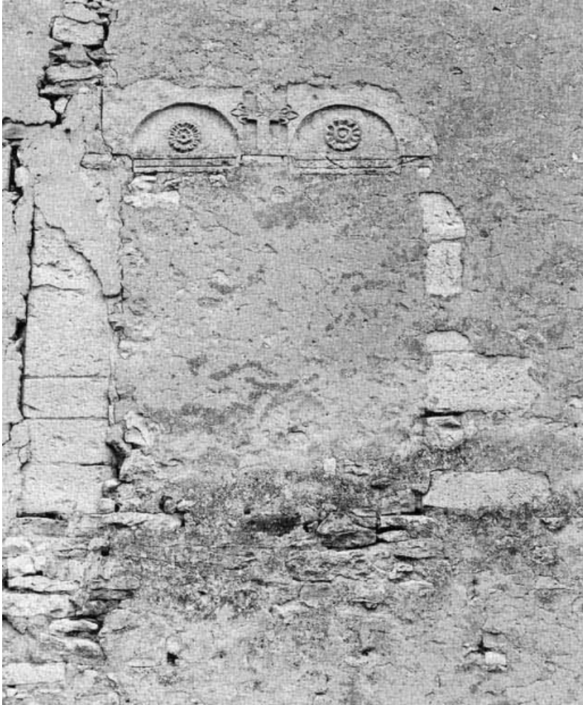
Détail du linteau d'une fenêtre murée sur la maison sise parcelle 1455, section D7 du cadastre de 1940. 21, Saint-Romain
