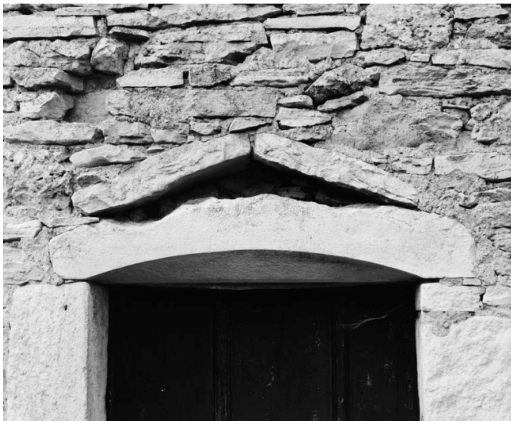
Détail du linteau sur la maison sise parcelle 1704, section D7 du cadastre de 1940. 21, Saint-Romain
