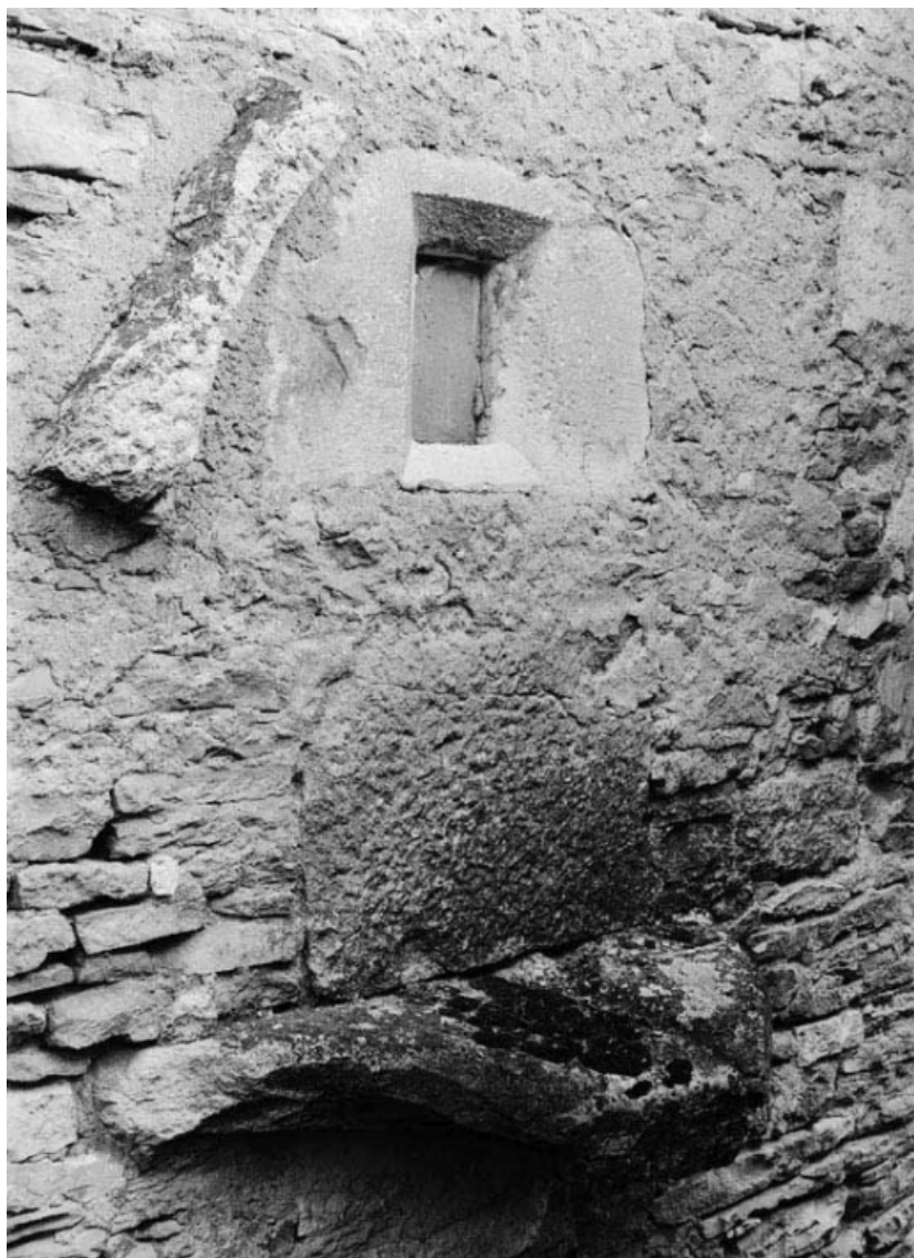
Jour et pierre d'écoulement sur la maison, sise parcelle 59, section D1 sur le cadastre de 1959. 21, Saint-Aubin
