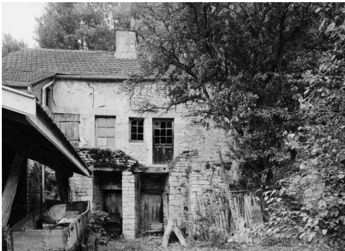
Vue d'ensemble de la maison sise parcelle 37b, section A1 sur le cadastre de 1959. 21, Saint-Aubin
