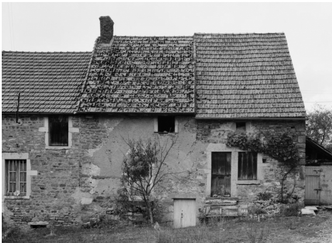
Vue d'ensemble des maisons sises parcelles 380-381, section A3 sur le cadastre de 1934. 21, Jours-en-Vaux
