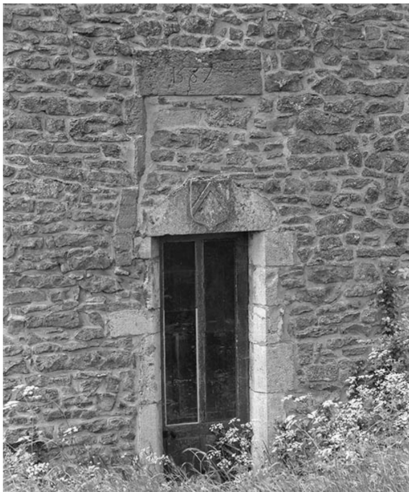
Détail de la porte avec blason et date de 1587, sur la tour nord-est, façade sur jardin. 21, Ivry-en-Montagne R.D. 17 d, lieudit : Coraboeuf
