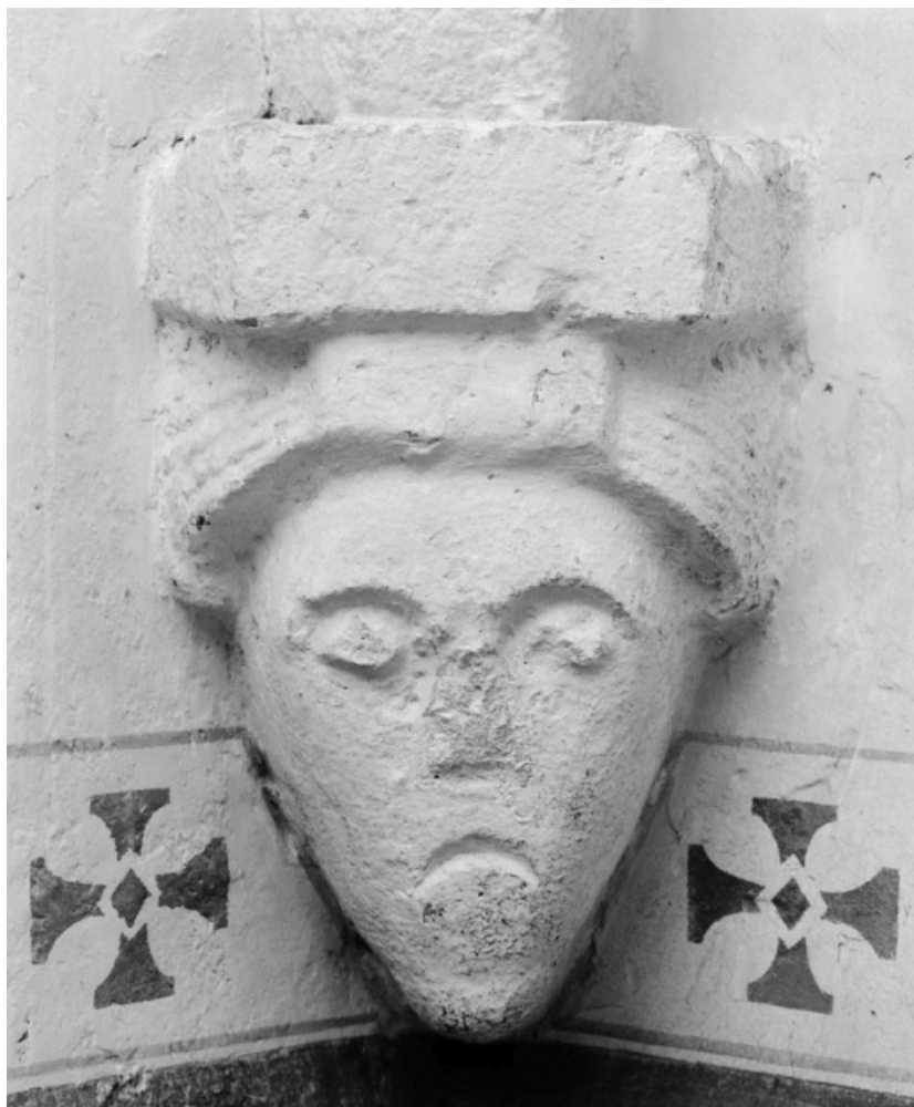
Culot postérieur droit de la chapelle. 21, Ivry-en-Montagne
