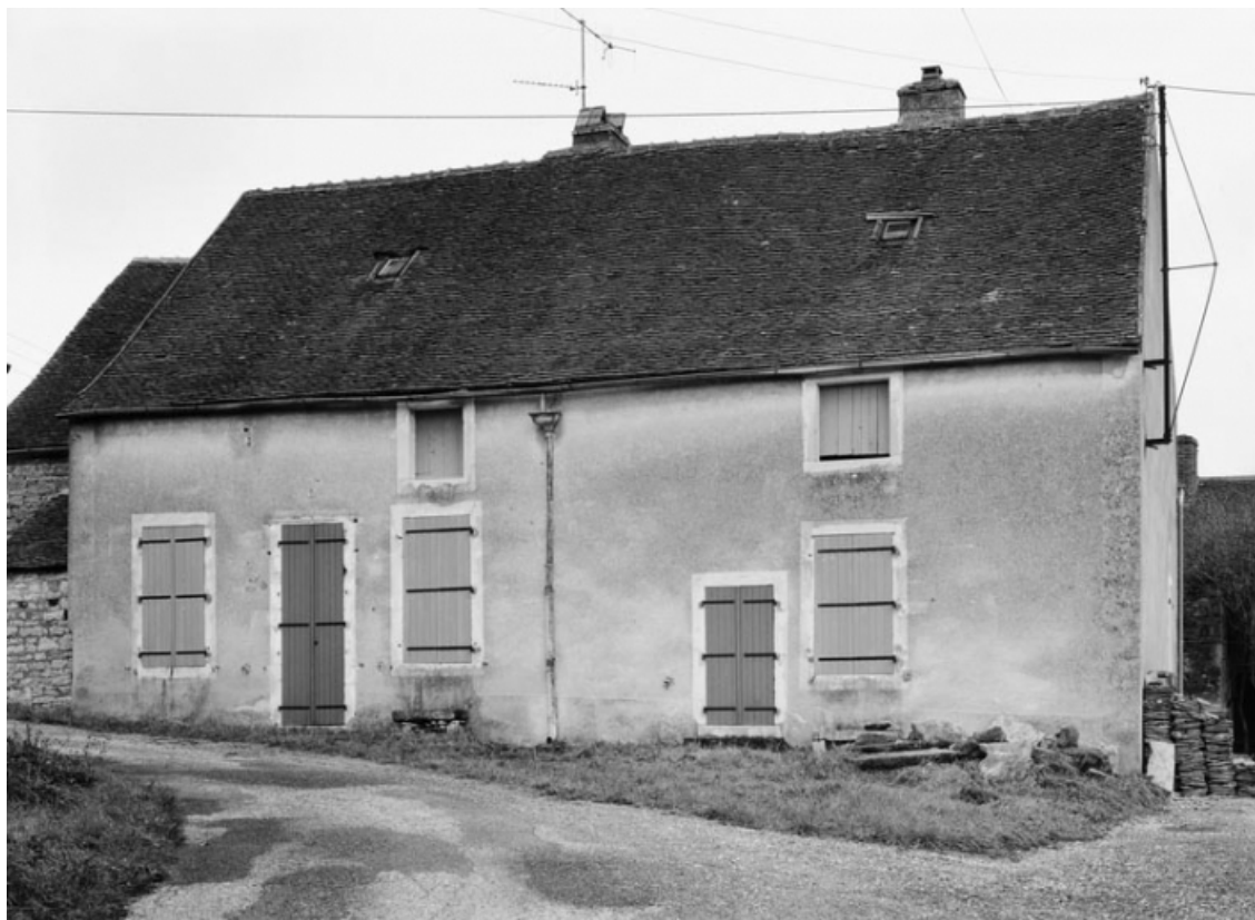
Vue d'ensemble de la maison sise parcelle 108, section AB du cadastre de 1955. 21, Ivry-en-Montagne
