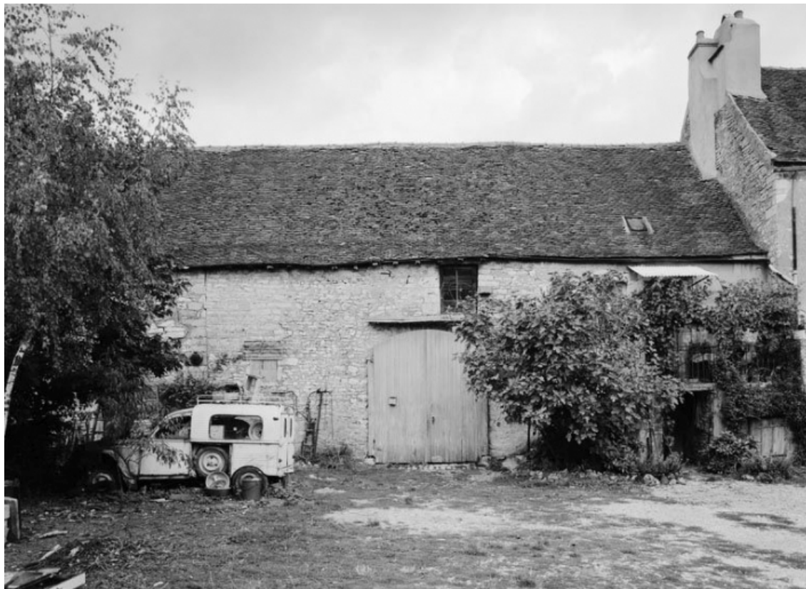
Vue de la maison sise parcelle 398, section A3 sur le cadastre de 1970. 21, Corpeau
