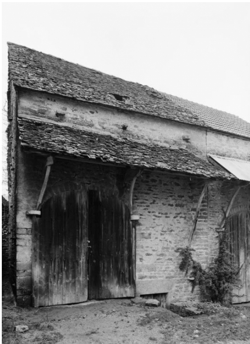
Vue d'ensemble de la maison sise parcelle 421, section C2 du cadastre de 1948. 21, Cormot-le-Grand
