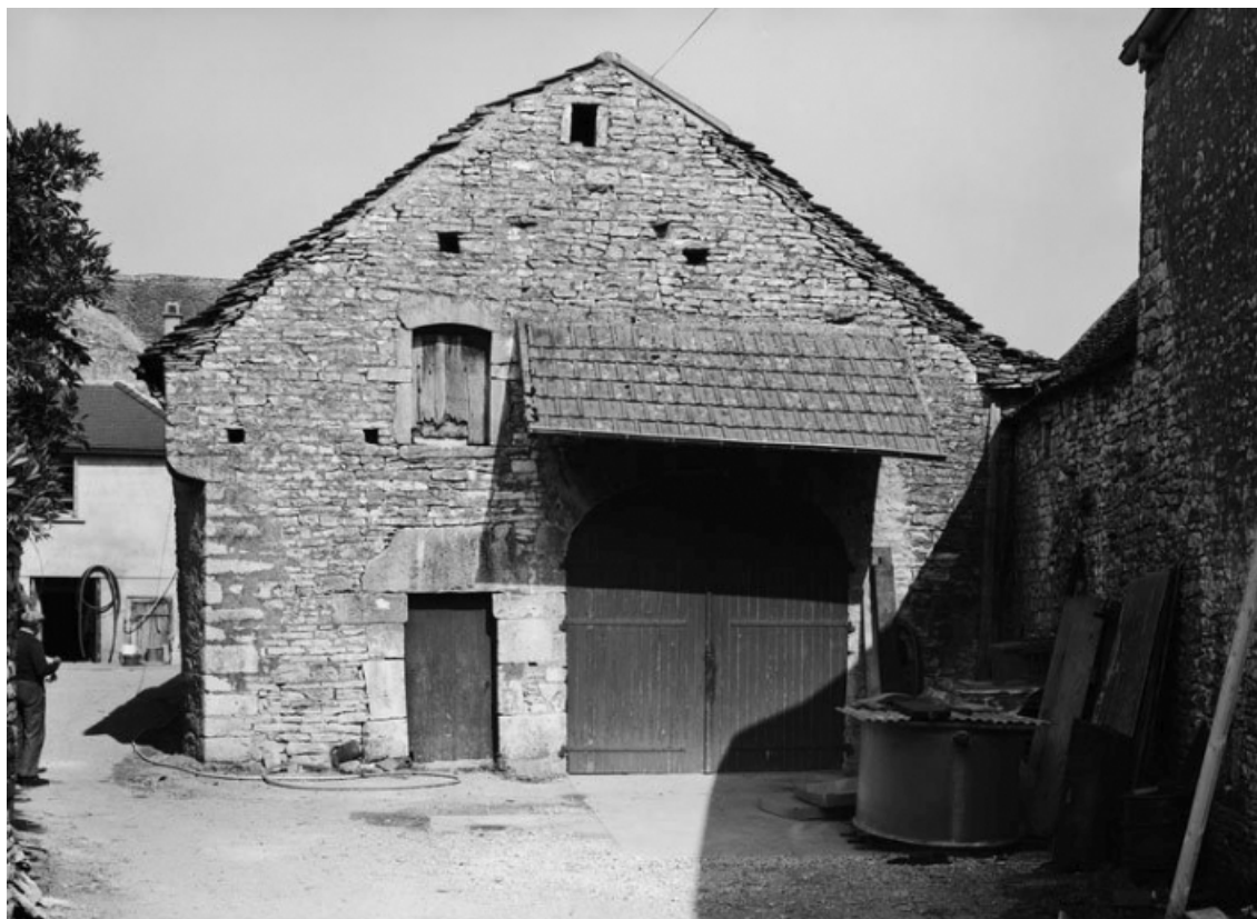
Vue du mur-pignon de la maison (ancienne cuverie) sise parcelle 237, section AK (cadastre de 1966). 21, Chassagne-Montrachet
