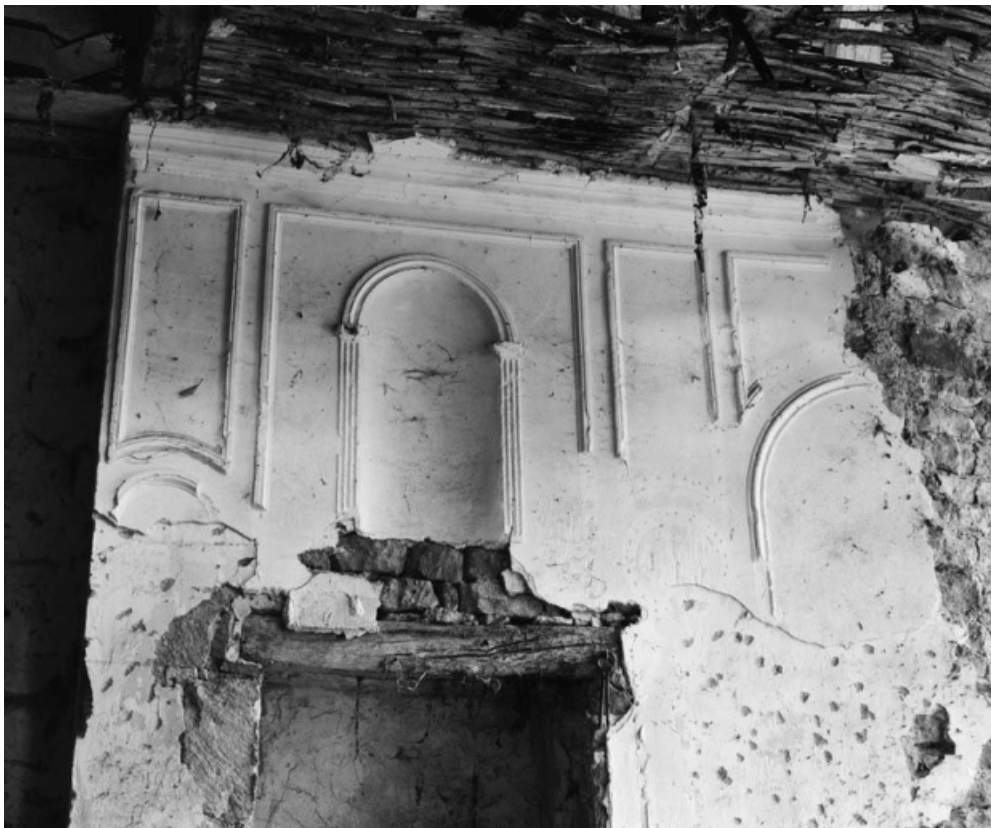
Détail du décor en stuc du mur gauche (en 1979). 21, Aubigny-la-Ronce R.D. 33, à l'ouest du village
