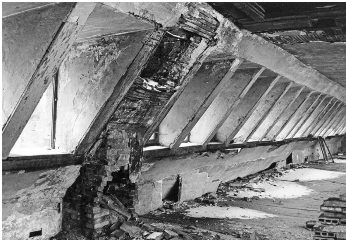
Vue intérieure du deuxième étage de comble : fenêtres et cheminée. 25, Badevel Grande Rue
