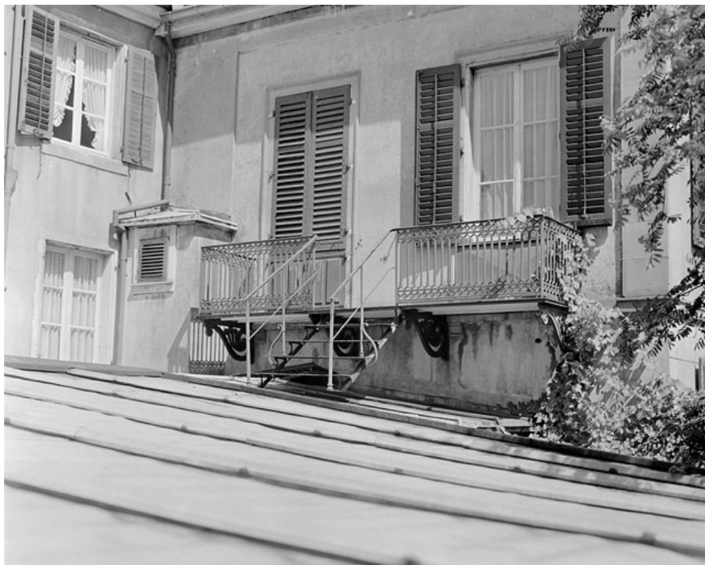
Balcon sur la façade postérieure du corps de bâtiment élevé en 1868. 25, Montbéliard, 20 rue Viette
