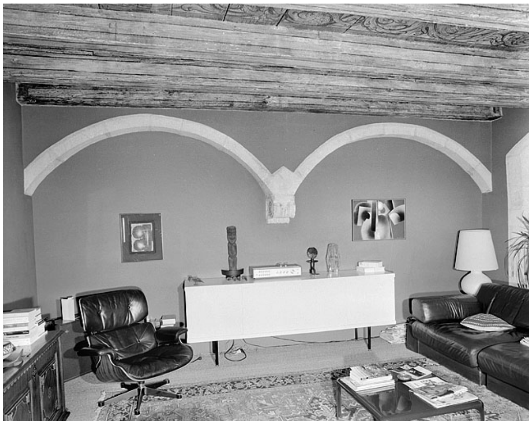
Arc double renforçant le mur de refend perpendiculaire à la façade sur rue dans la pièce principale au premier étage. 25, Montbéliard, 5 rue de la Sous-Préfecture
