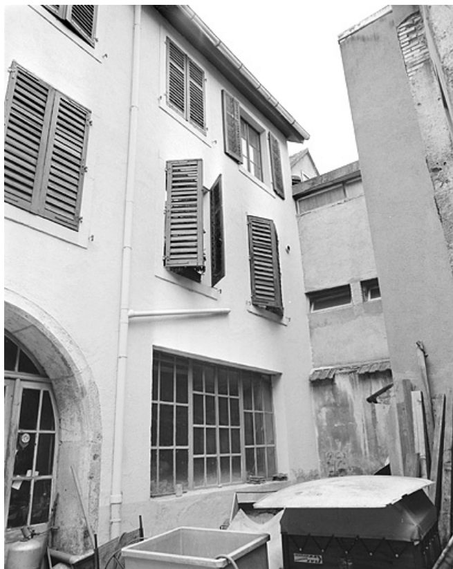
Partie droite de la façade sur cour du corps de bâtiment principal.
