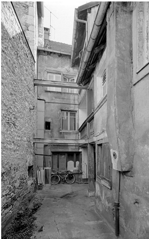
Façade sur cour du premier corps de bâtiment et galeries de liaison. 25, Montbéliard, 13 rue des Febvres
