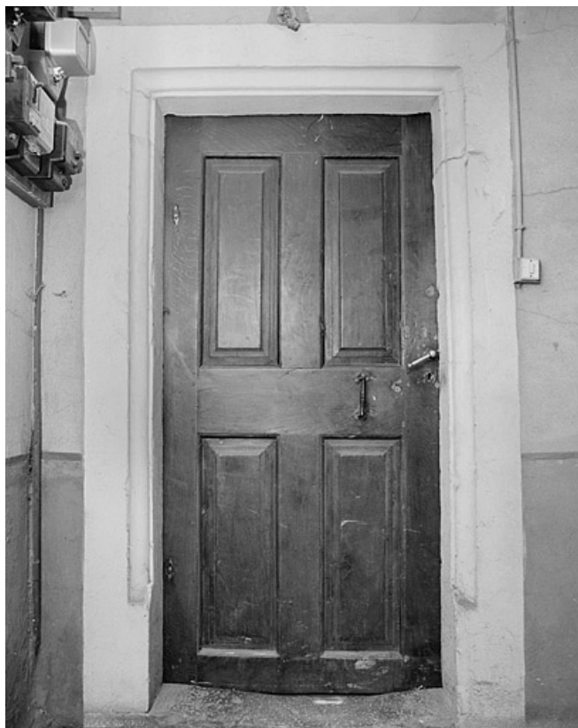
Porte donnant sur la galerie de liaison au premier étage du corps sur rue. 25, Montbéliard, 19, 21 rue Cuvier
