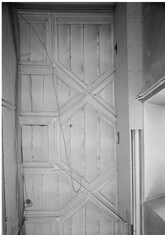
Plafond "à motifs complexes" [au premier étage du corps de bâtiment principal]. 25, Montbéliard place Denfert-Rochereau
