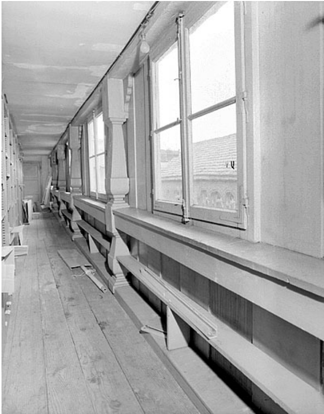
Galerie de distribution [au niveau du premier étage, partie occidentale]. 25, Montbéliard, 1 rue du Château
