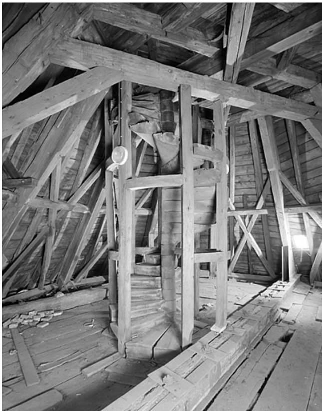
Tour Henriette. Charpente et escalier conduisant au lanternon. 25, Montbéliard cour du Château
