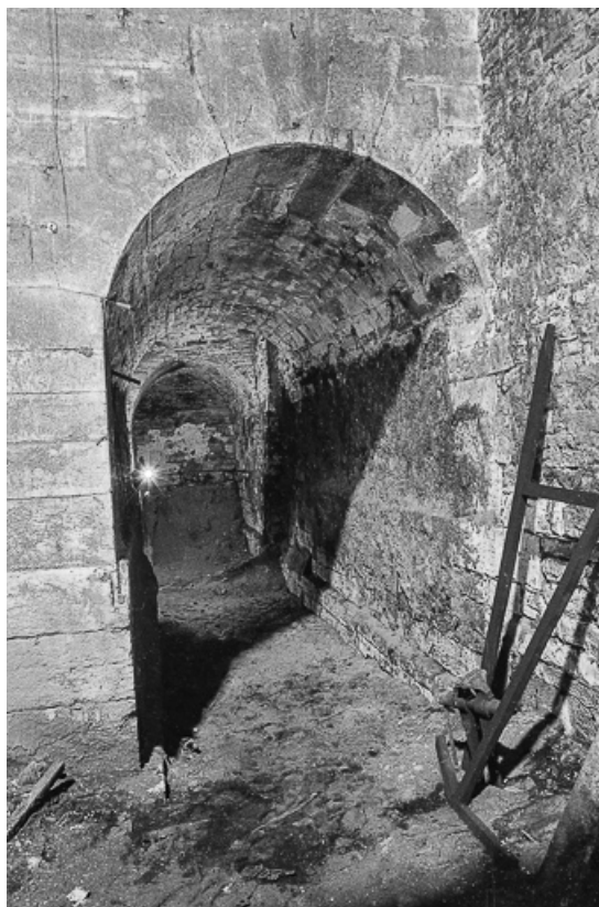
Base du haut fourneau en 1979. Galerie ouest. 70, Valay rue du Chatelard, lieudit : le Fourneau
