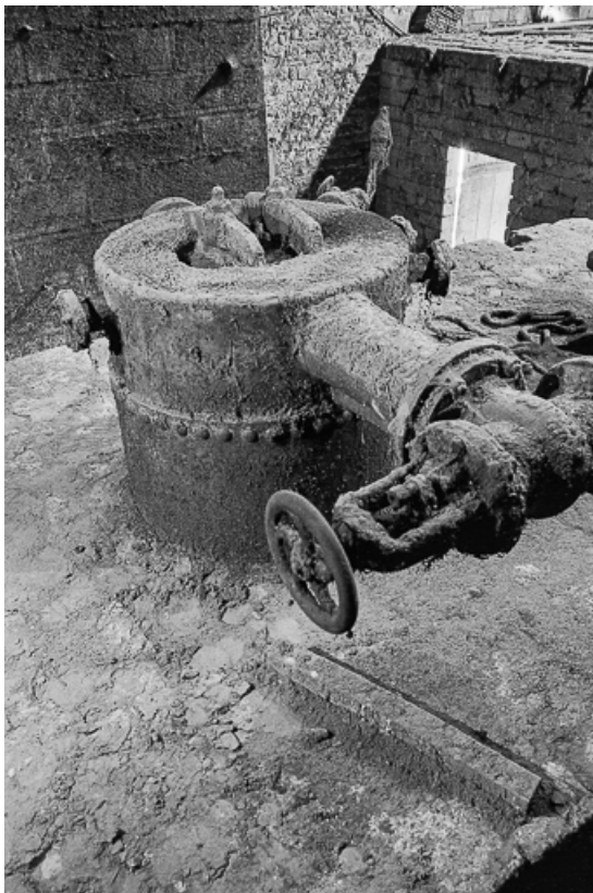
Partie supérieure de la chaudière. Vannage.
