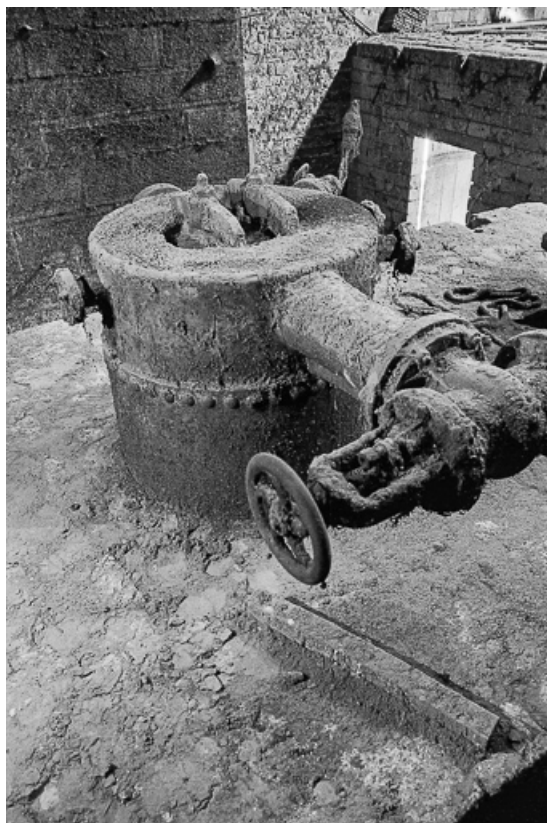
Partie supérieure de la chaudière. Vannage.
