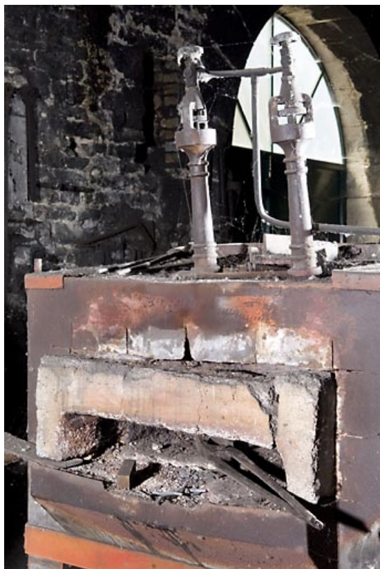
Atelier est. Détail de l'ouverture d'un four à gaz Thermidor.
