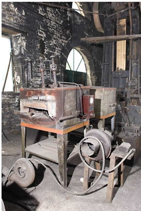
Atelier est. Fours à gaz Thermidor.
