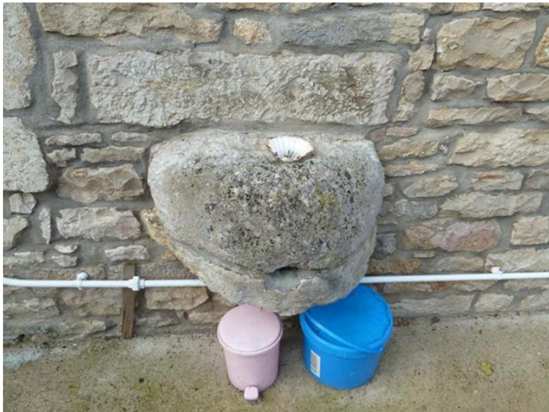
"Goulotte" d'évacuation de l'évier intérieur
