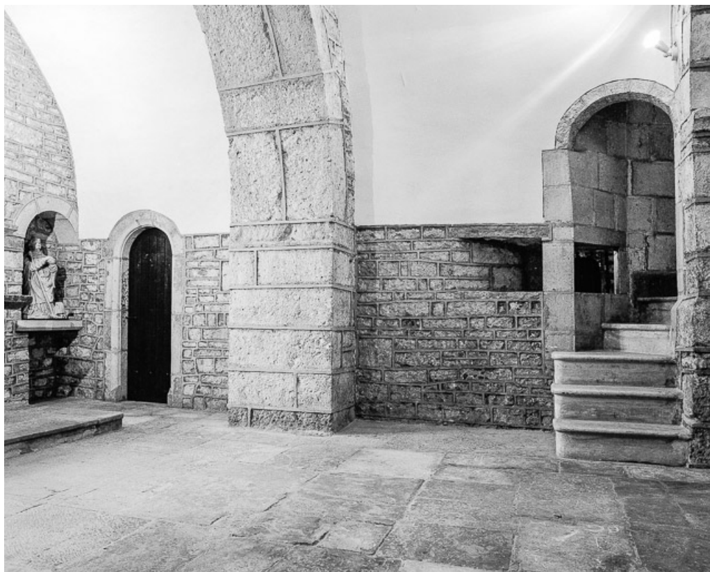
Bas côté droit, deuxième travée, mur ouest. 70, Marnay rue de l' Eglise
