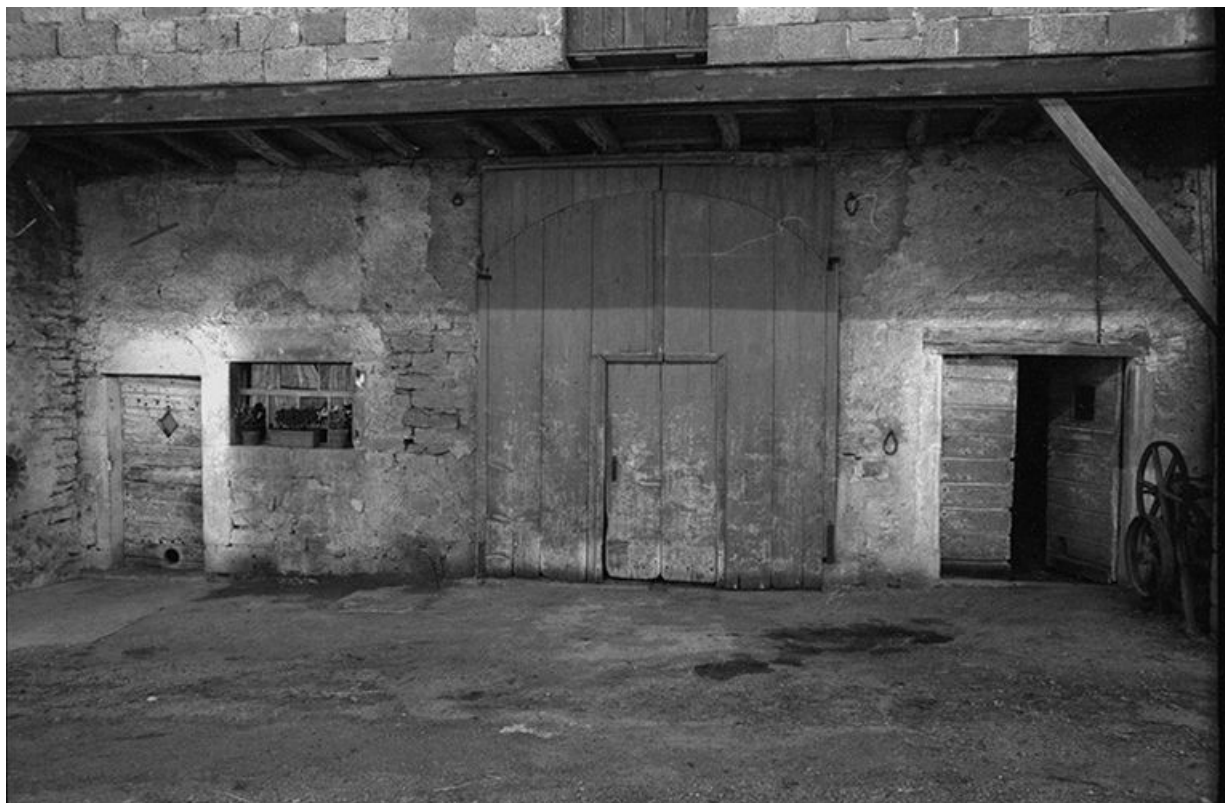
Ferme cadastrée 1957 A1 231 : portes des écuries de chaque côté de la grange. 39, La Marre
