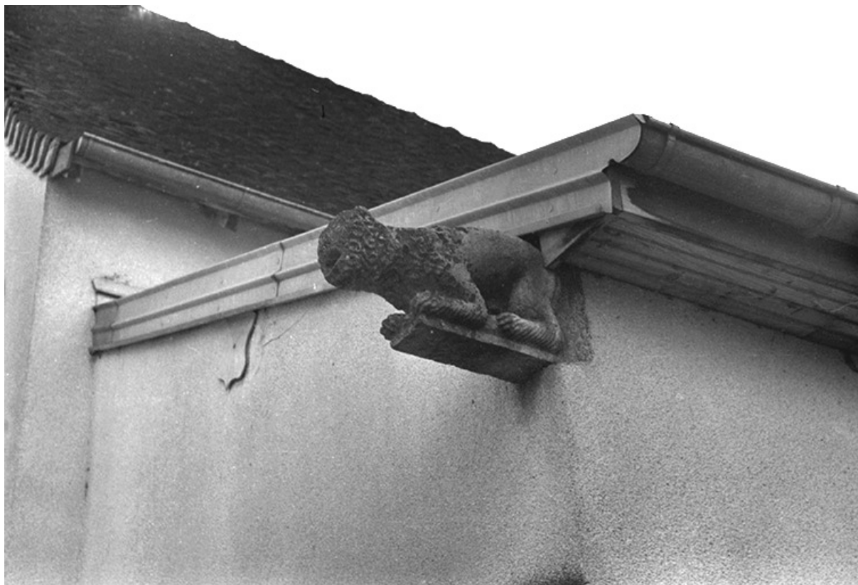
Gargouille en emploi sur le mur extérieur de la sacristie.
