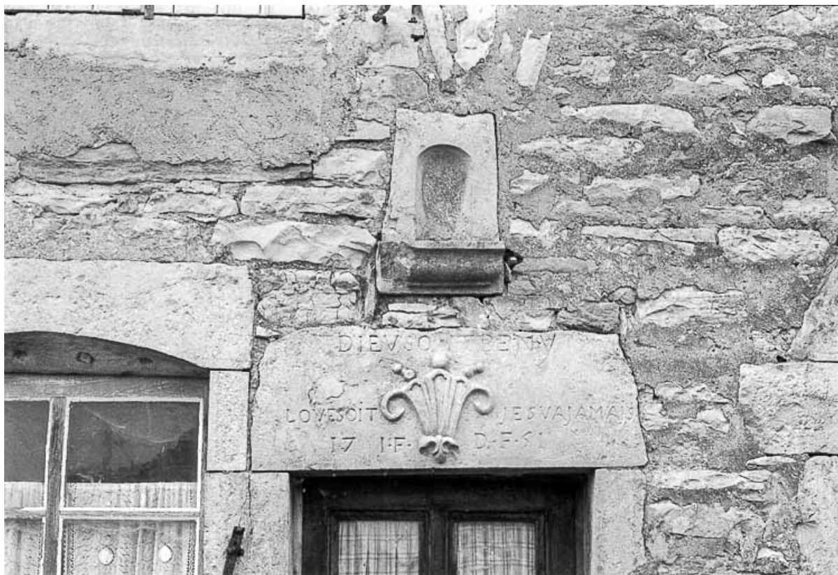
Maison située rue de la Roche : détail du linteau de porte avec inscription : 1751 39, Château-Chalon
