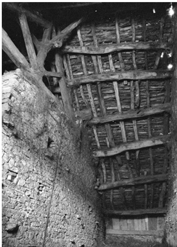
Ferme cadastrée 1960 B 109, située au lieudit La Peyrouse : charpente de toit de laves. 39, Baume-les-Messieurs
