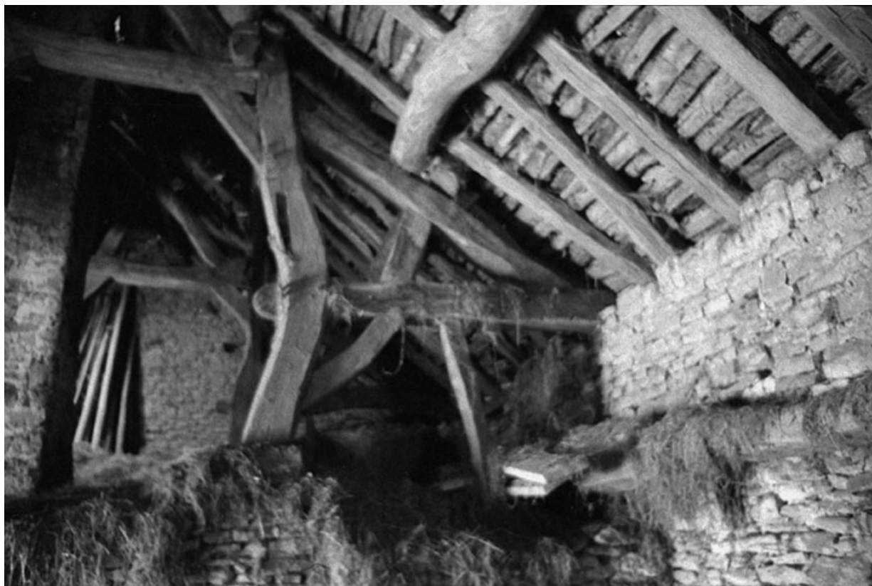
Ferme cadastrée 1960 B 107, située au lieudit La Peyrouse : détail de la charpente d'un toit en laves. 39, Baume-les-Messieurs
