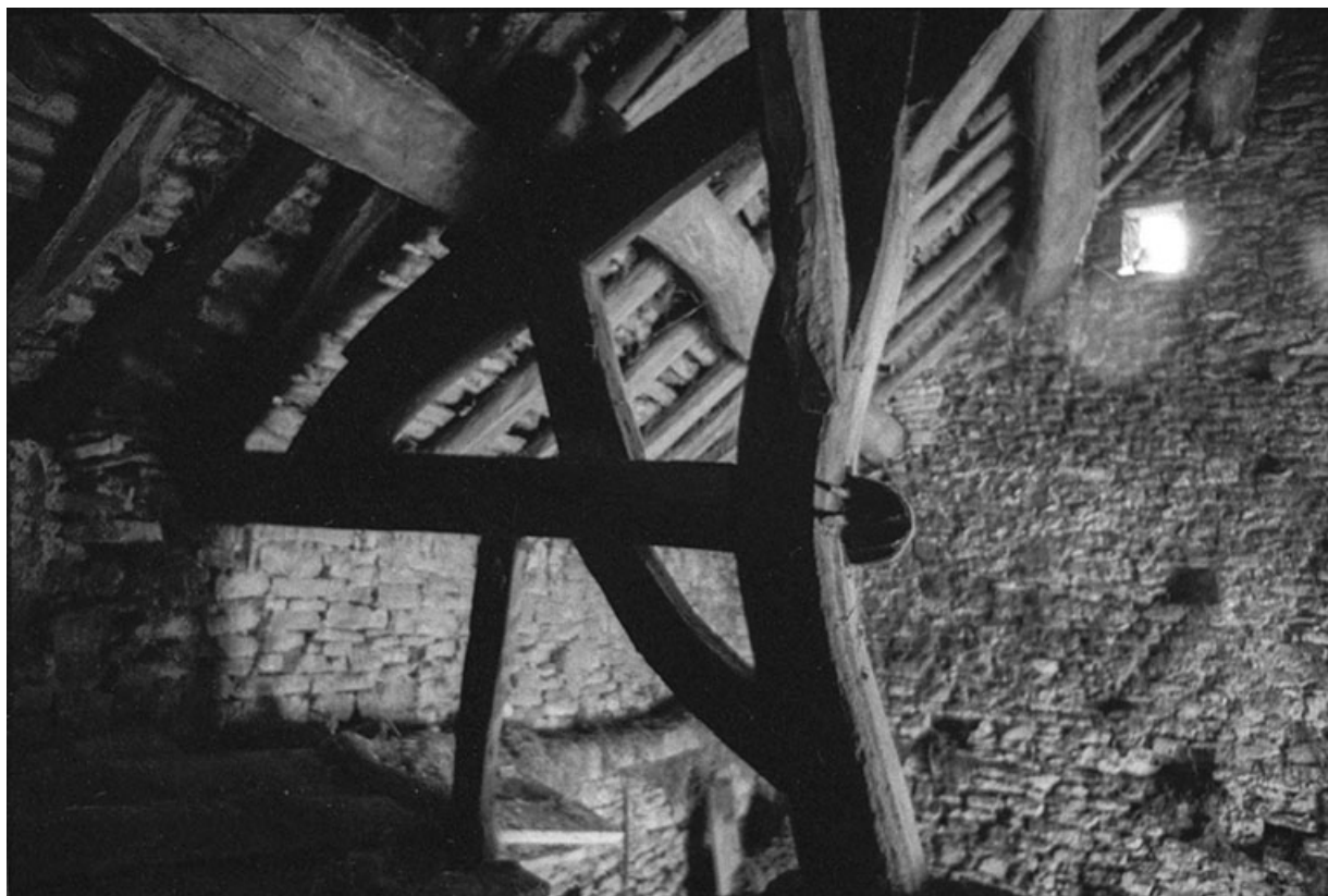
Ferme cadastrée 1960 B 107, située au lieudit La Peyrouse : détail de la charpente d'un toit en laves. 39, Baume-les-Messieurs
