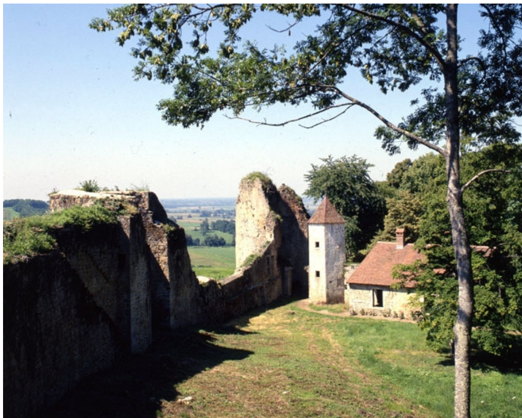
Rempart médiéval du Bourg-Dessus, volontairement échanté pour ouvrir le parc sur les paysages des Côtes du Jura, en 1990. 39, Arlay, lieudit : Arlay-le-Château
