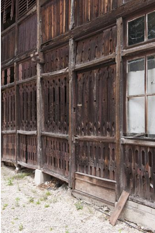
Détail de la façade ouest des communs (remise ou écurie). 25, Audincourt, 72 rue de Valentigney
