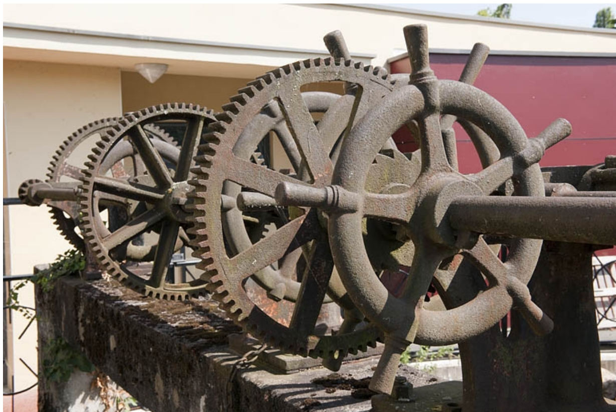
Système de vannage du bief de dérivation. Détails de volants et engrenages. 25, Audincourt allée de la Filature
