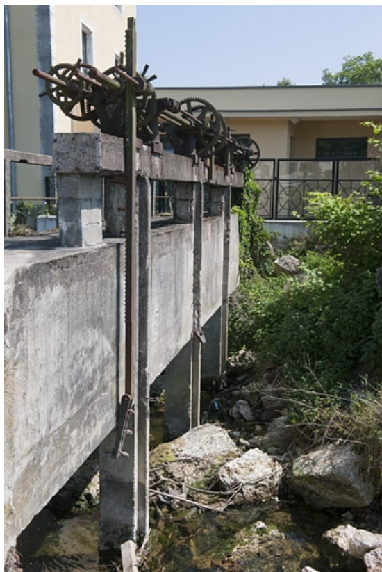
Système de vannage du bief de dérivation.
