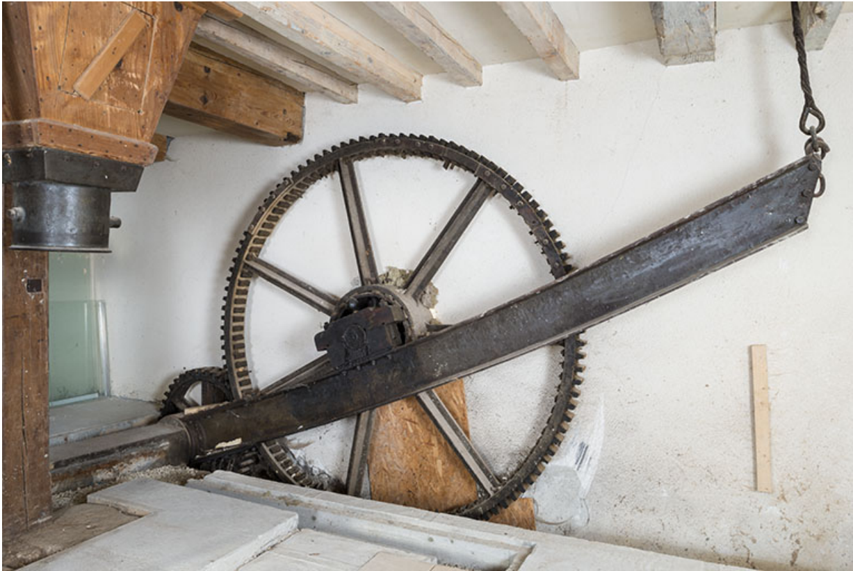
Système de levage de la roue suspendue (amont) : volant engrené (axe de la roue) et levier. 25, Vuillafans, 14, 16 route de Pontarlier
