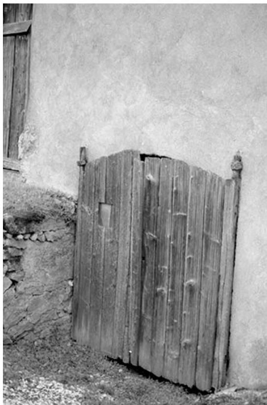
Ferme située rue des Vergers, cadastrée 1972 AB 62 : la porte de l'écurie. 25, Trépot
