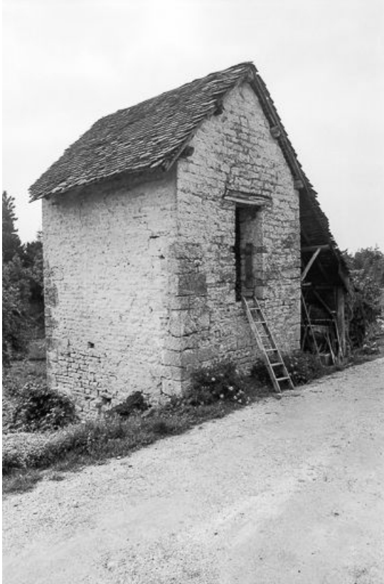
Toit à porc (soue) vue de trois quarts gauche. 25, Malbrans rue des Vignes
