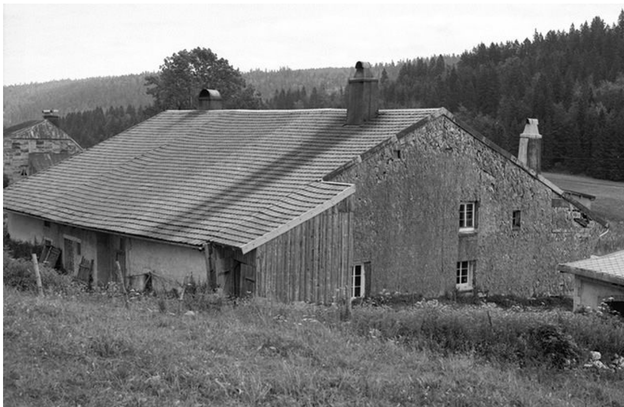
Ferme datée de 1774, située 34 avenue des Turquoises : façade postérieure et pignon gauche. 25, Petite-Chaux
