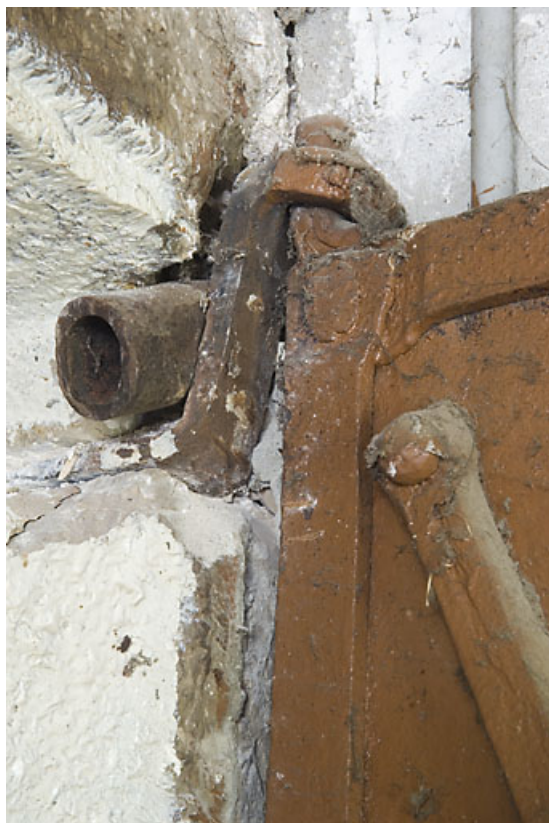
Appartement du 2nd étage : gond de la porte coupe-feu. 25, Jougne, 17 rue du Faubourg
