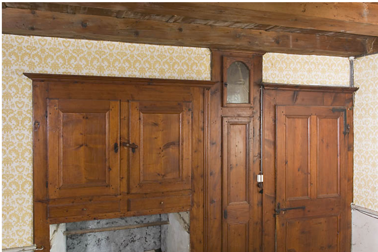
Grande chambre (du 1er étage ?) : placard, emplacement de l'horloge comtoise et porte. 25, Jougne, 17 rue du Faubourg
