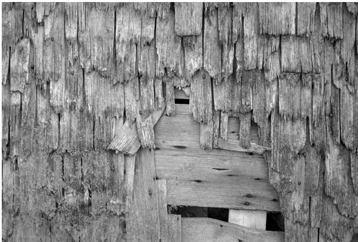
Ferme datée de 1870, située 5 rue de la Grande Fontaine : tavaillons sur le pignon gauche. 25, Chaux-Neuve
