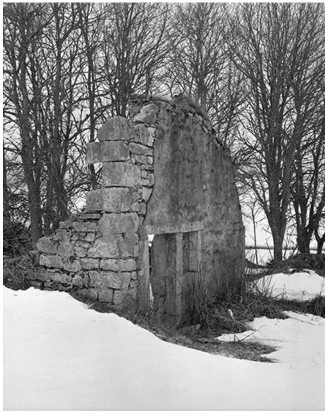
Ruine d'une ferme située au lieudit Les Cerclevaux : la chaîne d'angle. 25, Chaux-Neuve
