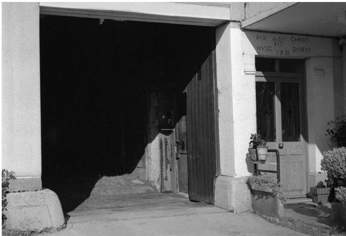
Ferme datée de 1731, située rue du Chalet, cadastrée 1972 AB 62 : entrée de grange et entrée d'habitation. 25, Châtelblanc
