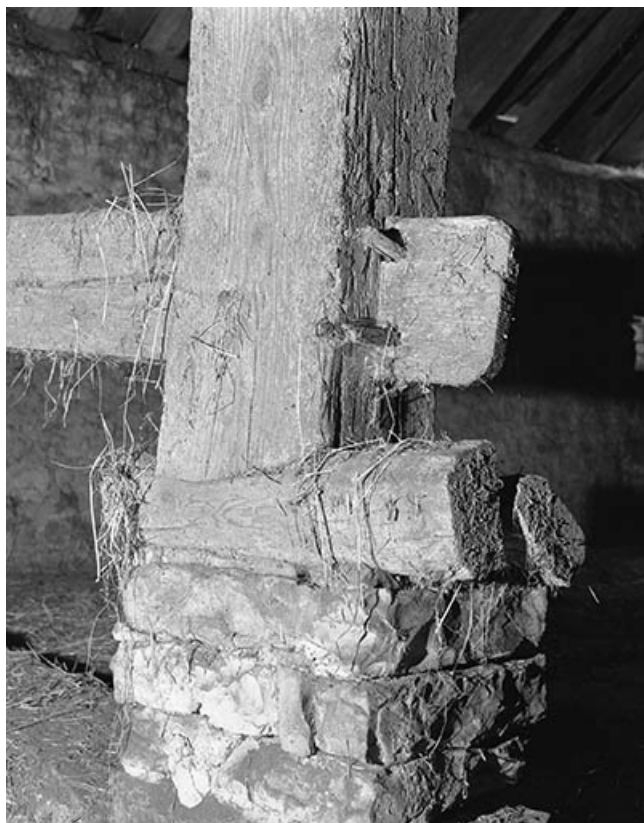
Partie inférieure d'un poteau de charpente au niveau de la partie habitation.
