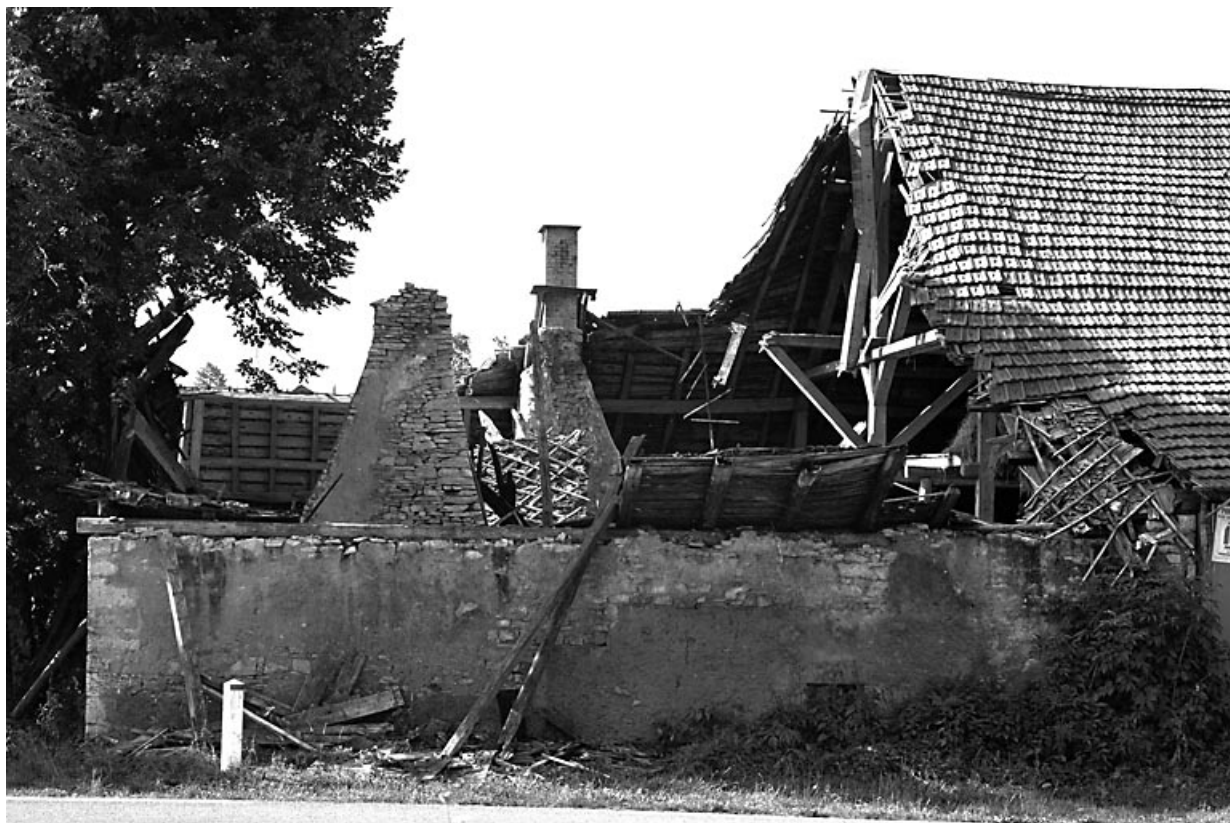
Etat de la partie d'habitation sur le mur de croupe gauche.
