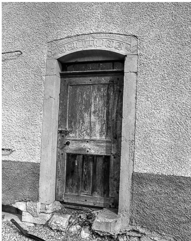
Ferme située au lieu-dit Les Charmottes : porte d'entrée latérale. 25, Montlebon
