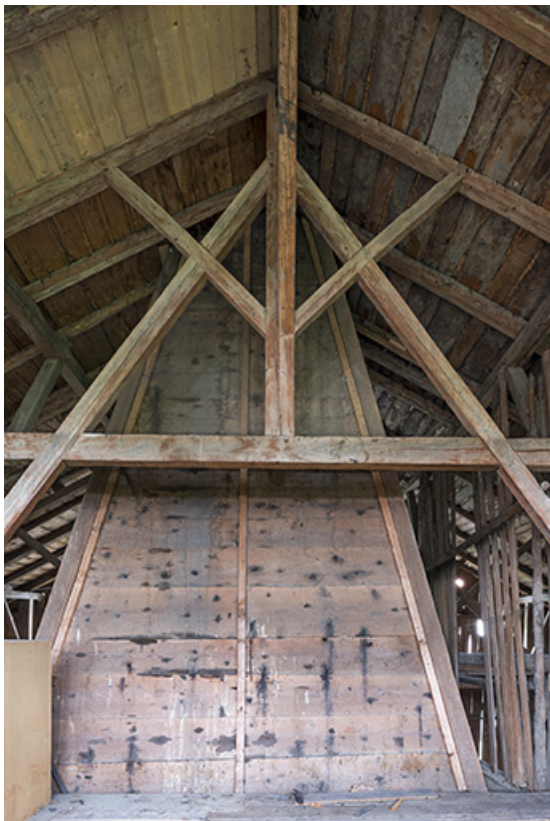
Intérieur, grange : hotte du "tué" central et charpente. 25, Grand'Combe-Châteleu 3e ferme, lieudit : les Cordiers
