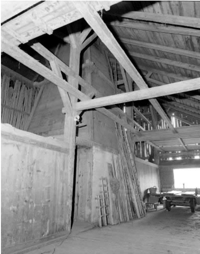
Hotte du "tué" droit vu depuis l'aire de roulage.
