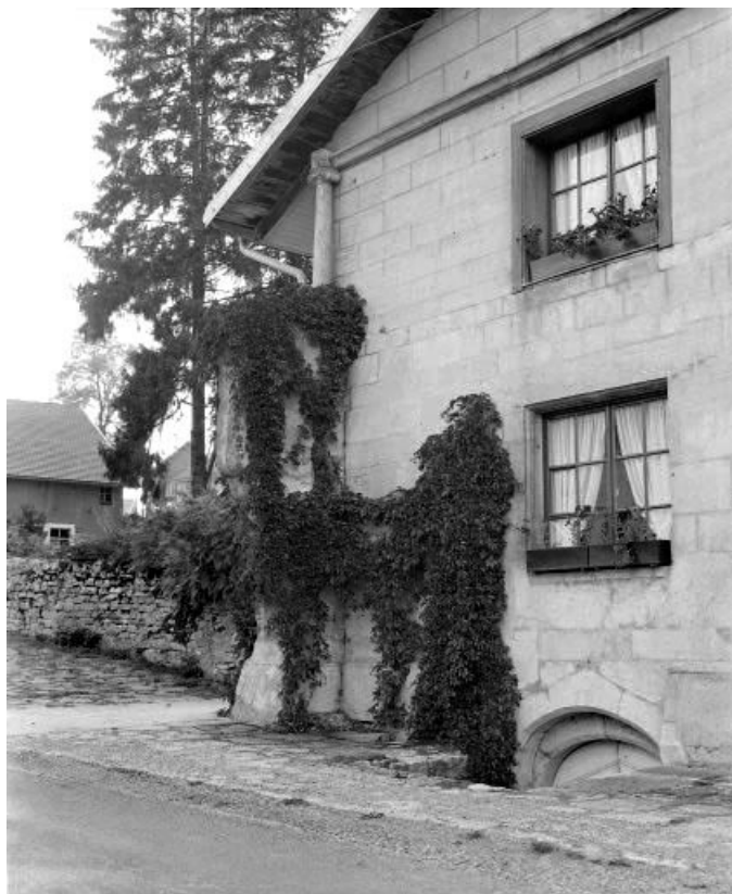
Façade antérieure : partie gauche avec contrefort et entrée de cave. 25, Grand'Combe-Châteleu, 10 Bas de Grand Combe
