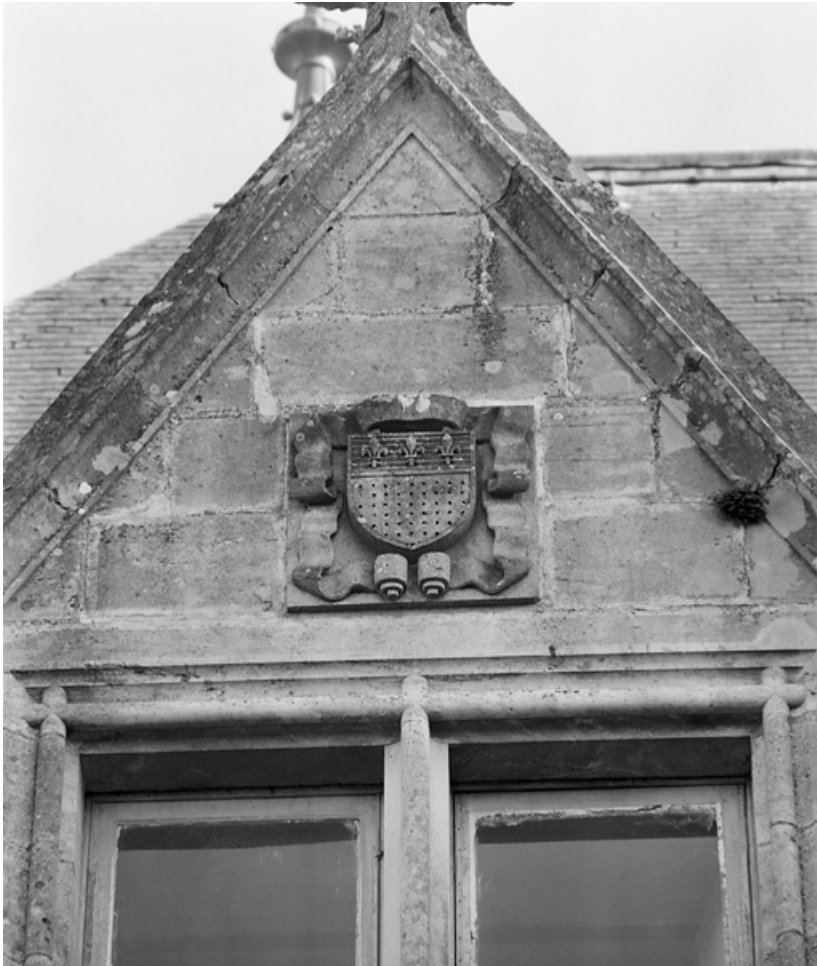
Détail des armoiries sur le corps de logis, le long de la route. 58, Châtillon-en-Bazois
