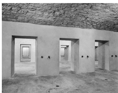
Bâtiment Cavalier, salles successives couvertes de voûtes en berceau segmentaire. Phot. Jérôme Mongreville IVR43_20003900196X
